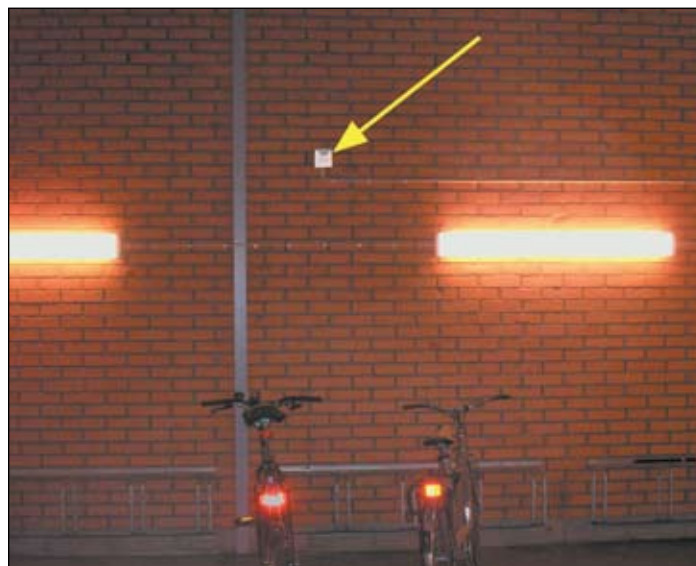
Forkert placeret detektor ved cykelparkering
